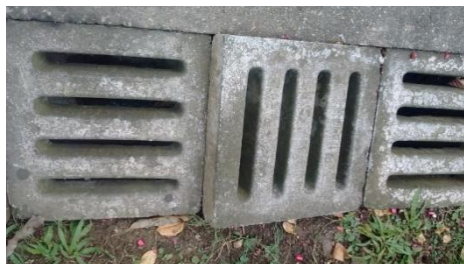
Fotografía N° 7 Rejilla de cárcamo en concreto
