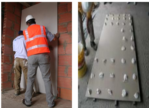
Fotografía N°6 Revoque seco en placa superboard
