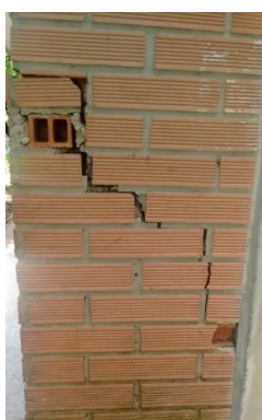
Fotografía N°9 Chapas de ladrillo
